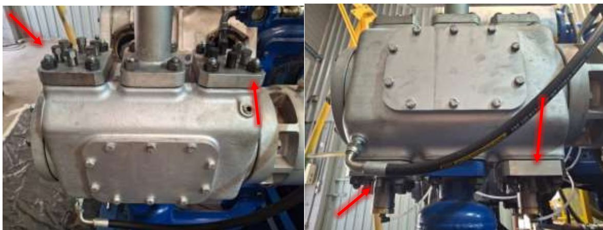
Figura 3 – Cilindro 3º Estágio Válvulas de descarga – Original.
