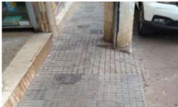
IMAGEM 4: RAMPA DE ACESSO SEGUIDA DE DEGRAU.
